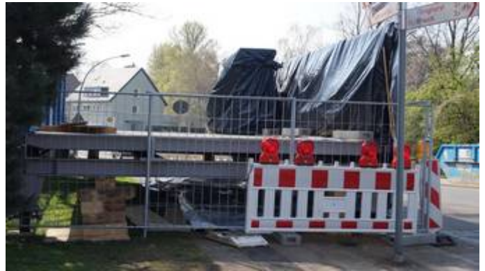
Auf dem Foto: abgelegte und eingewickelte Brückenelement Seit März wartet die Brücke Lütkestraße darauf, endlich über die Gleise der Bundesbahn gelegt zu werden. Bürgerproteste und die Beharrlichkeit der DKP setzten den Neubau der Brücke überhaupt erst durch. Nach vielen Verzögerungen sollte sie nun Anfang 2014 fertig werden. Später wurde der Termin auf März verschoben: Das Ergebnis ist bekannt. Die Geduld der Anwohner ist jetzt am Ende! Die Brücke Lütkestraße ist inzwischen zu einem Symbol des Versagens der Stadtverwaltung geworden!
